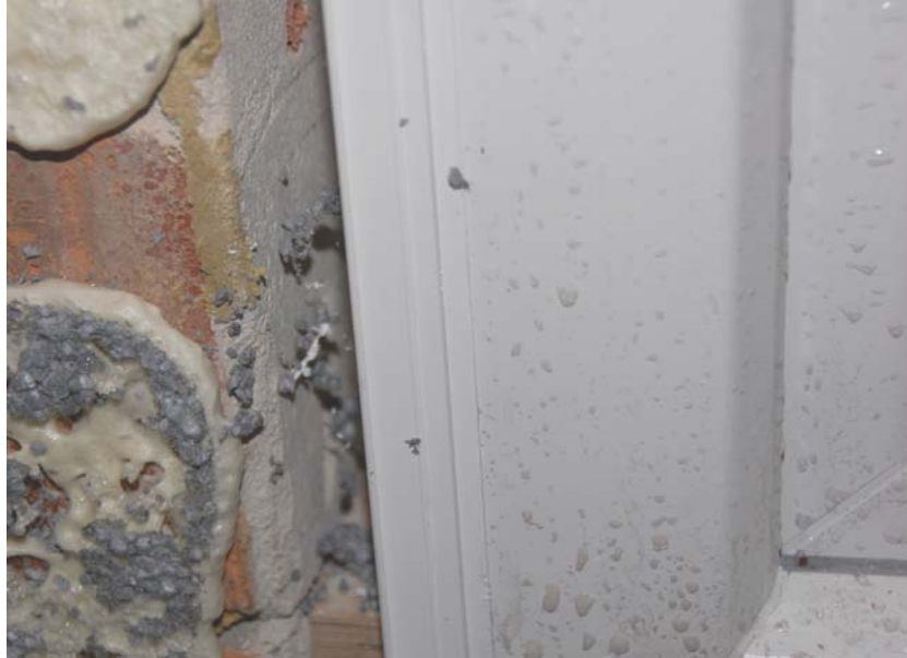
Bild 7 Geöffnete Anschlüsse nach Abschluss der Prüfungen. Gute Haftung des Schaumklebendes zum Blendrahmen (Abriss an der TPE-Schlaufe).
